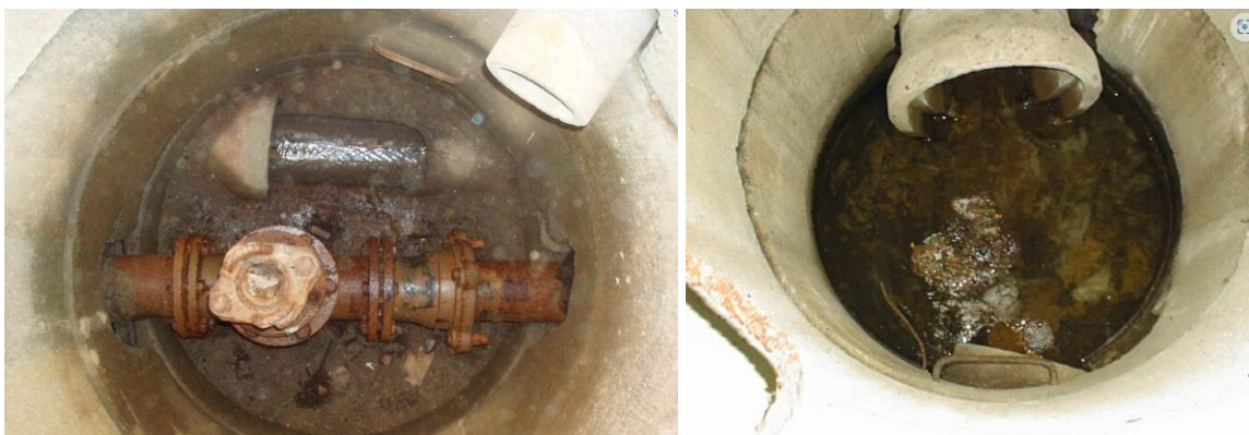
Figur 16 - Eksempel på eldre avløpskum, med samlet avløp og vannledning, samt avløpskum uten renneløp
