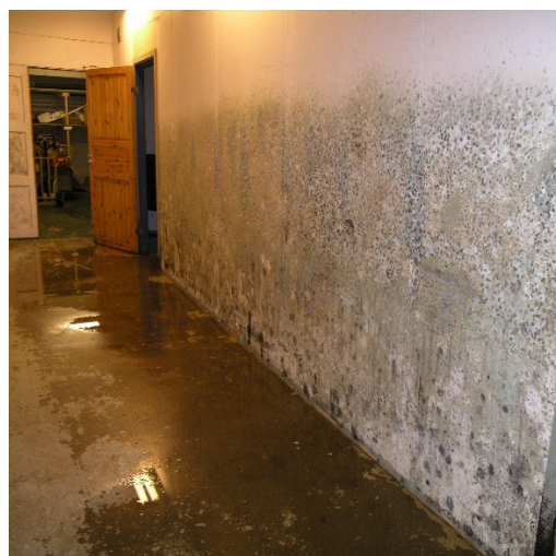
Muggsoppvekst som følge av vannskade.
